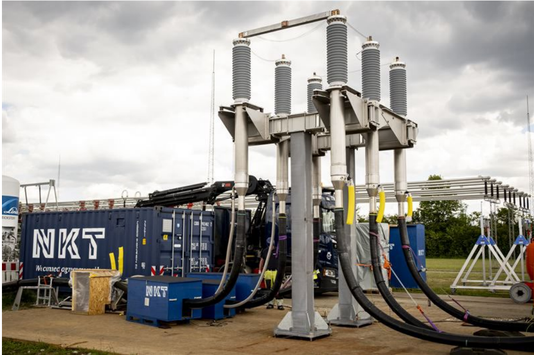
Figuur 3.2 Test-opstelling van een supergeleidende kabel in het project SuperLink (Foto: NKT 2024)
