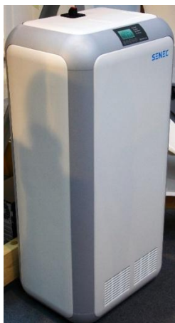
Type thuisbatterij dat betrokken was bij het incident
