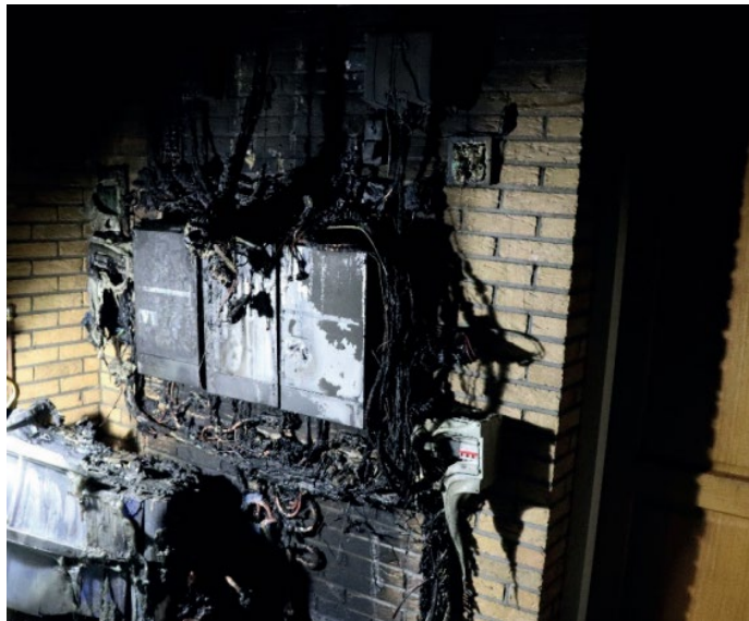
Schade door de brand (Brandweer Twente, 2023)
