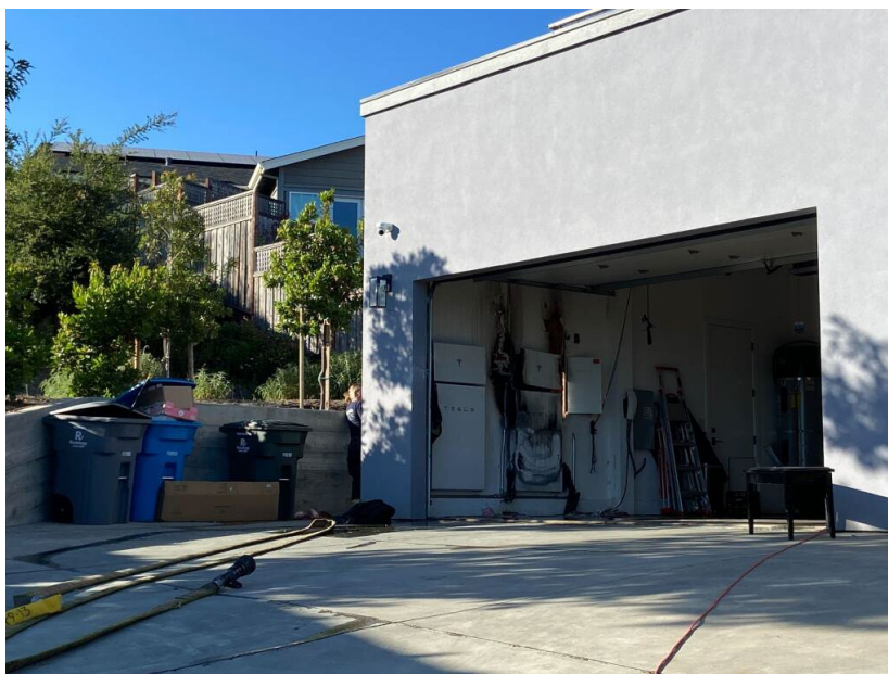
Garage waar het incident heeft plaatsgevonden met een Tesla Powerwall
