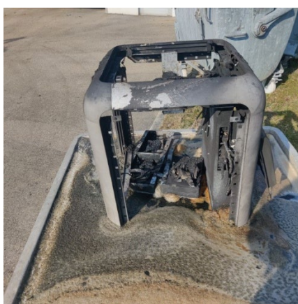
Schade aan de thuisbatterij
