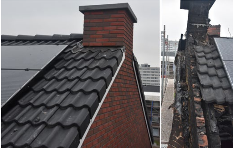
Figuur B2.5 Schil met EPS isolatie tegen gevel en op het dak voor (links) en na de brand (rechts). Bron: TBO-VRR/ZHZ
