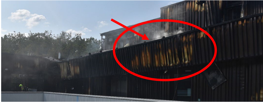
Figuur 1.15 De brand verspreidt zich via de gevelconstructie richting de schacht
