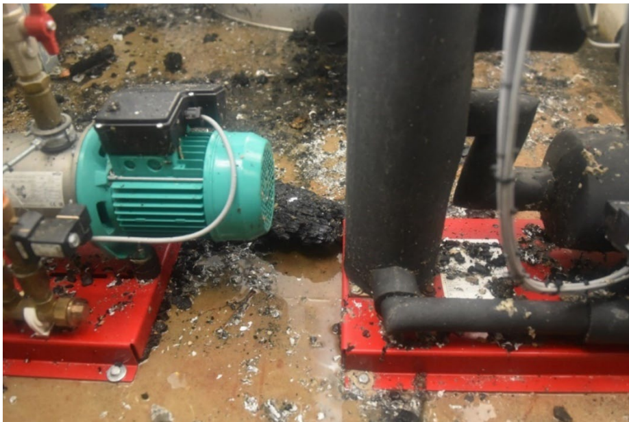
Figuur 1.116 Brandresten en gesmolten aluminium in de kelder op -2
