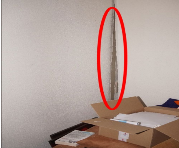
Figuur 2.2 De buitenwand werd door de explosie \pm 10 cm naar buiten geduwd
