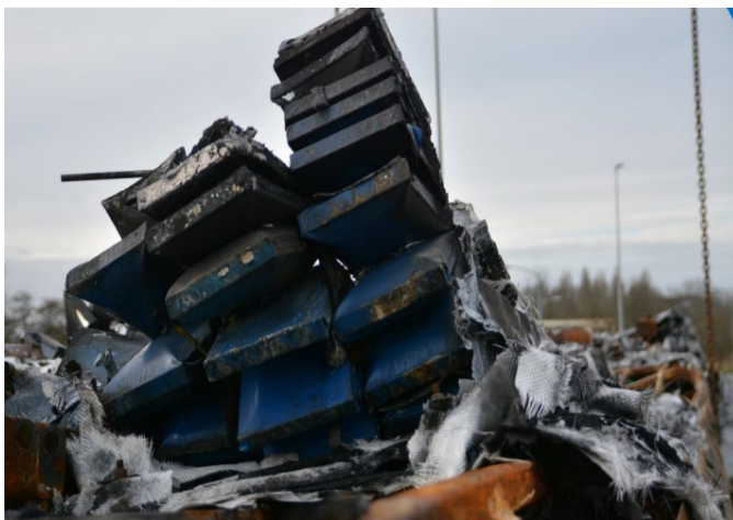
Figuur 3.13 Opgezwollen batterijpakketten op het dak van de bus
