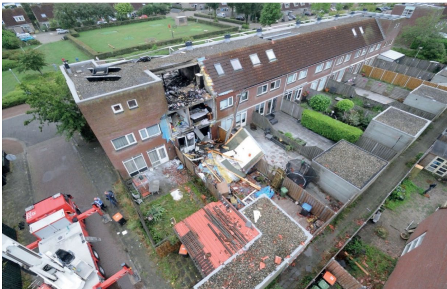
Figuur 2.3 Schade aan de achtergevel en het dak van de woning
