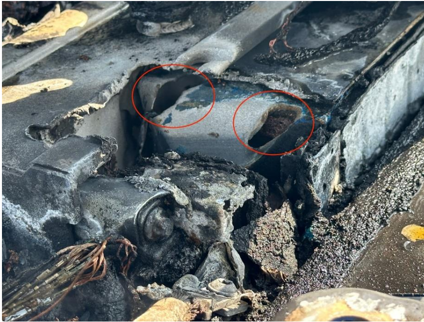
Figuur 5.3 Schade of snijgaten na inzet uhd-blussysteem
