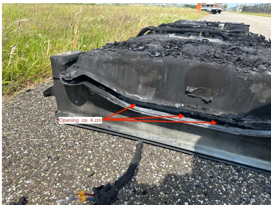
Figuur 5.5 Opening batterijpakket door overdruk
