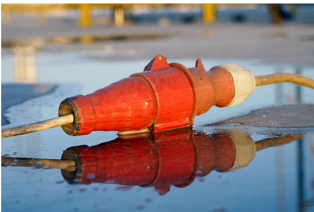
Figuur 4.1 Gevaarlijke situatie: stroomkabels in een waterplas (foto: Shutterstock)
