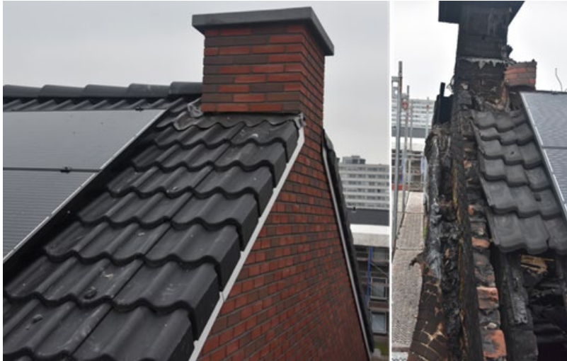
Figuur B2.5 Schil met EPS isolatie tegen gevel en op het dak voor (links) en na de brand (rechts). Bron: TBO-VRR/ZHZ
