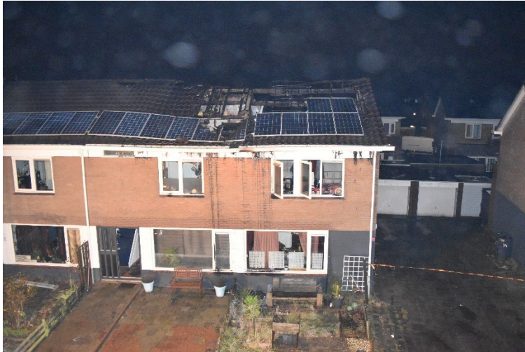
Figuur B2.3 Restanten van gesmolten EPS op de gevels. Bron: TBO-BR Zeeland
