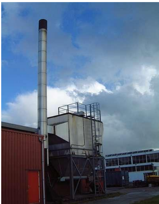
Figuur 4 Elektrostatische rookfilterinsginstallatie
