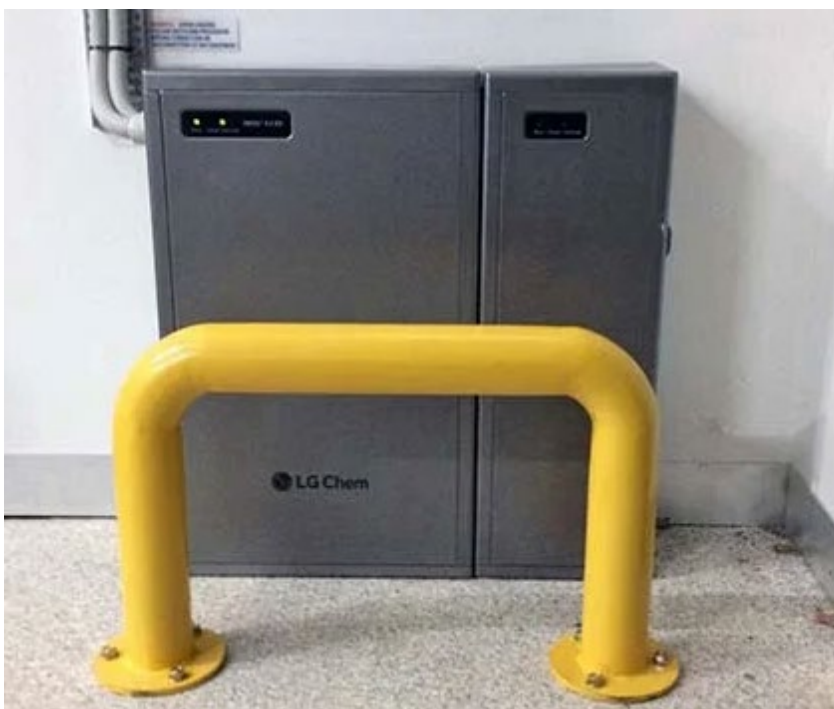
Figuur 3.6 Een beschermende constructie moet extra bescherming bieden aan een thuisbatterij wanneer de batterij het risico loopt op externe impact (bron: https://renew.org.au/renew-magazine/solar-batteries/new-battery-installation-rules/ )
