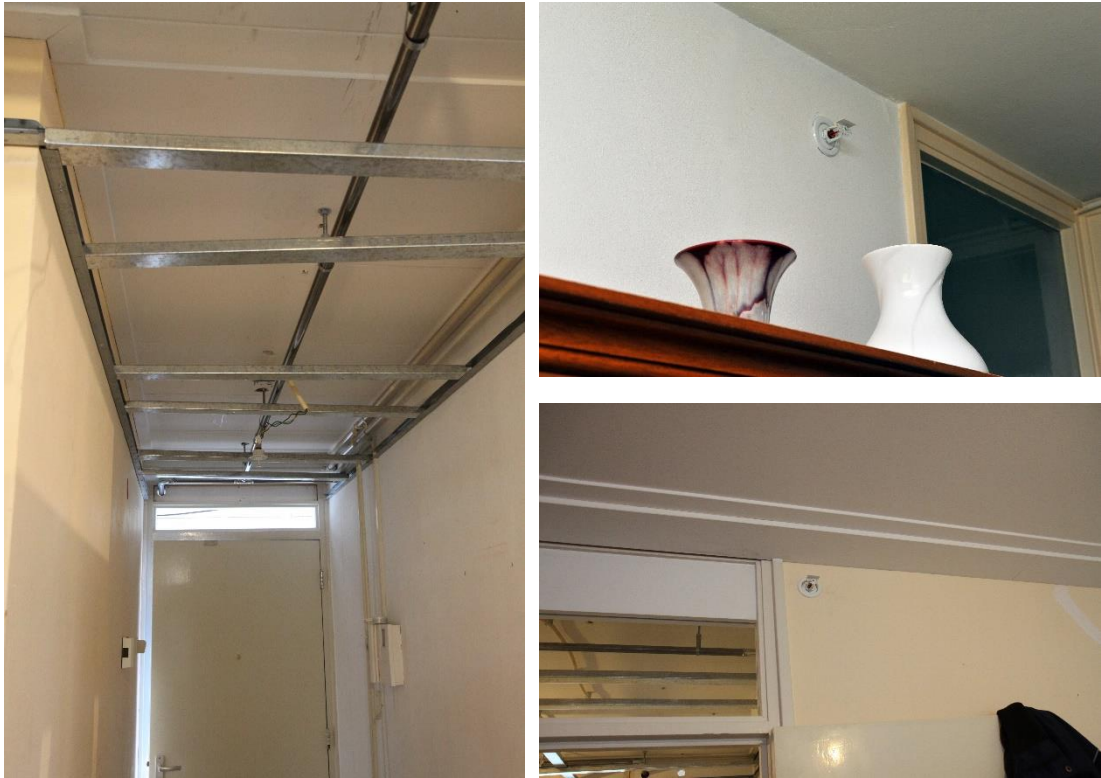
Afbeelding 3.6 Dit woongebouw is voorzien van een sprinklerinstallatie, zowel in de appartementen als in de gangen
