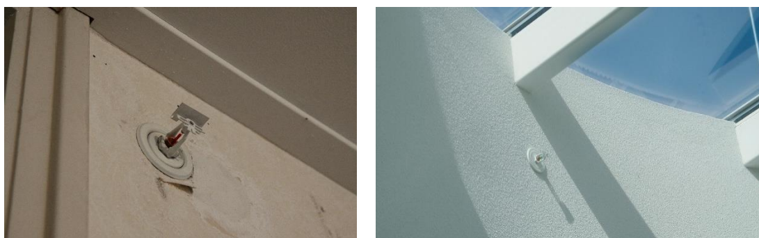
Afbeelding 3.1 Woningsprinklers in de muur
