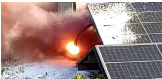
Figuur 3.11 Vlamboog dichtbij de combinerbox, ingezoomd (Incidentonderzoek VRBZO)
