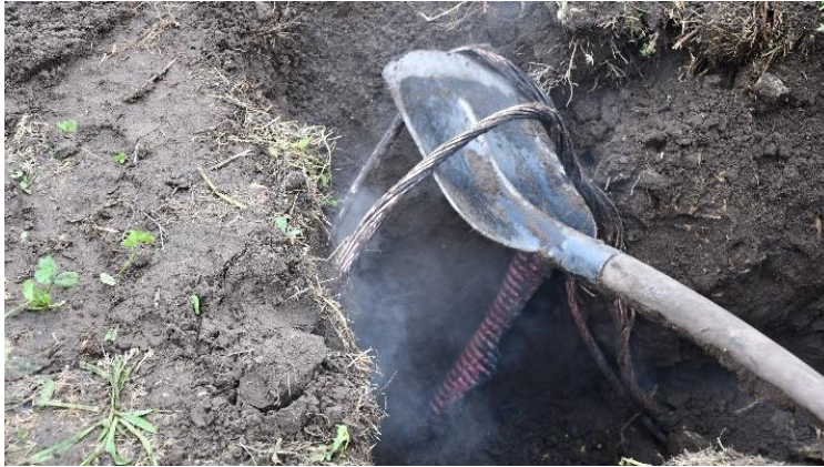
Figuur 3.12 De ondergrondse kabels worden opgegraven. De kabelisolatie is weg gesmolten en de grond is verbrand (Incidentonderzoek VRBZO)
