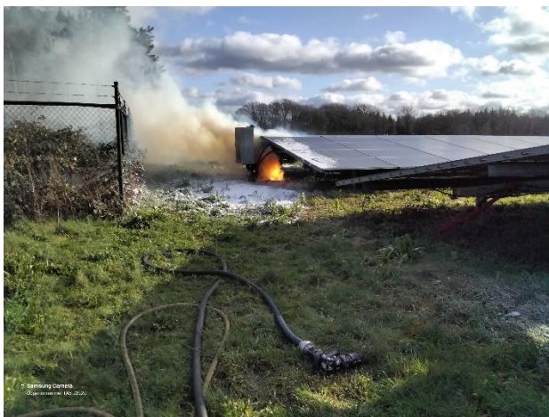
Figuur 3.10 Inzet van blusschuim na uitbreiding van de brand naar de combinerbox (Incidentonderzoek VRBZO)
