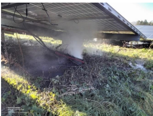
Figuur 3.9 Rookontwikkeling aan de onderkant van een zonnepaneel als gevolg van de ondergrondse kabelbrand (Incidentonderzoek VRBZO)
