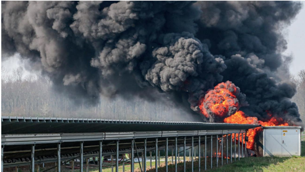
Figuur 3.13 Brand transformatorhuis van zonnepark in Emmeloord in 2020 (Regio 25)
