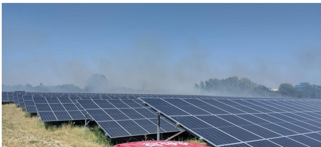
Figuur 3.1 Rookontwikkeling tijdens de brand op zonnepark Sas van Gent (TBO Zeeland, 2022)
