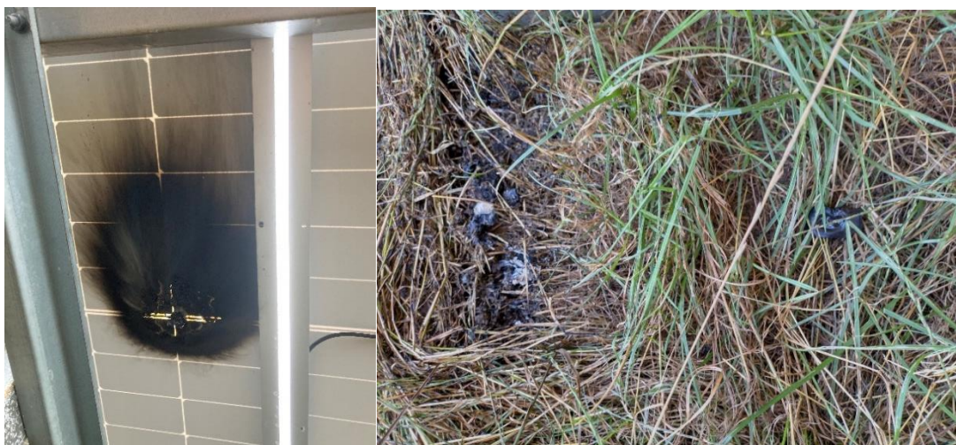
Figuur 3.3 Hotspot onder zonnepaneel in rij 37 (links) en druppels gesmolten materiaal dat van het paneel op de grond is gevallen (rechts) (TBO Zeeland, 2022)
