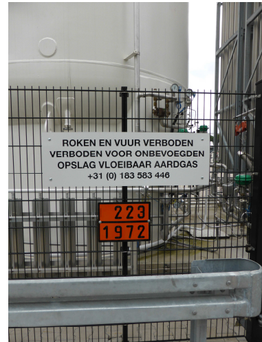
Herkenbaarheid van LNG &amp; contactgegevens exploitant in de nabijheid van opslagtank
