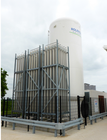
Opslagtank met warmtewisselaar
