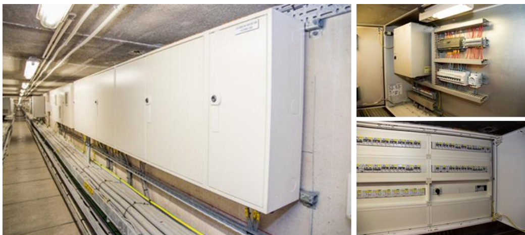
Figuur B4.1 Voorbeeld van aaneengesloten metalen kasten ten behoeve van de tunnelinstallaties
