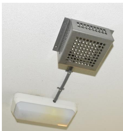
Figuur 2.7 Afgeschermde rookmelder in een trappenhuis (Bron: Brandweer Gelderland-Midden)
