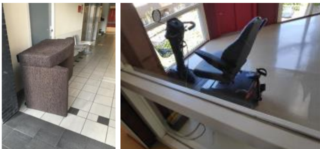
Figuur 2.5 Een bank in de gang en een scootmobiel zijn voorbeelden van spullen die volgens het Bbl niet in de vluchtroute mogen staan. Ze produceren bij brand veel rook en een scootmobiel is een mogelijke ontstekingsbron.
