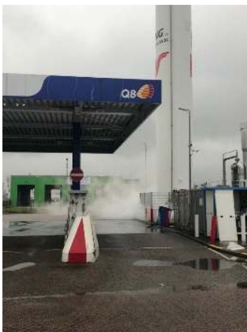
Afbeelding 8.1 Lekkage van de LNG-tank (foto: Veiligheidsregio Rotterdam-Rijnmond)
