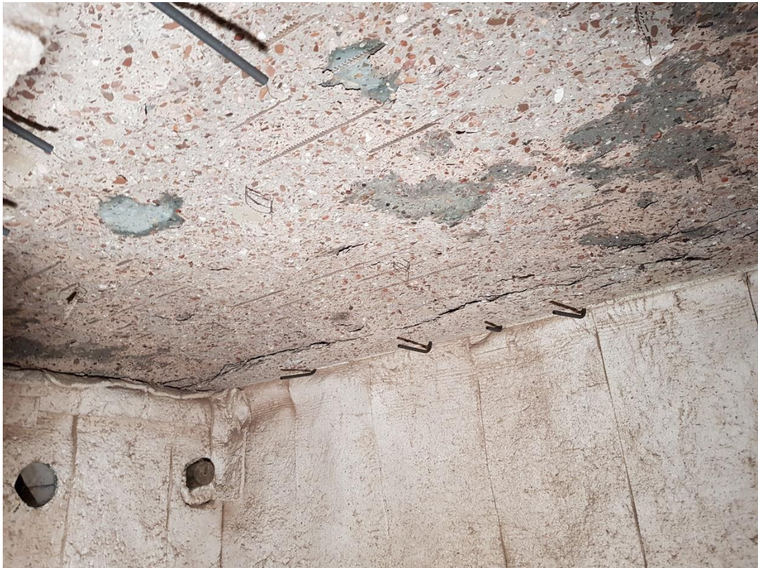
Afbeelding B 1.3: Betonafspatting in de Victory Boogie Woogietunnel (Den Haag). Foto: Frank Haring (projectorganisatie Rotterdamsebaan)
