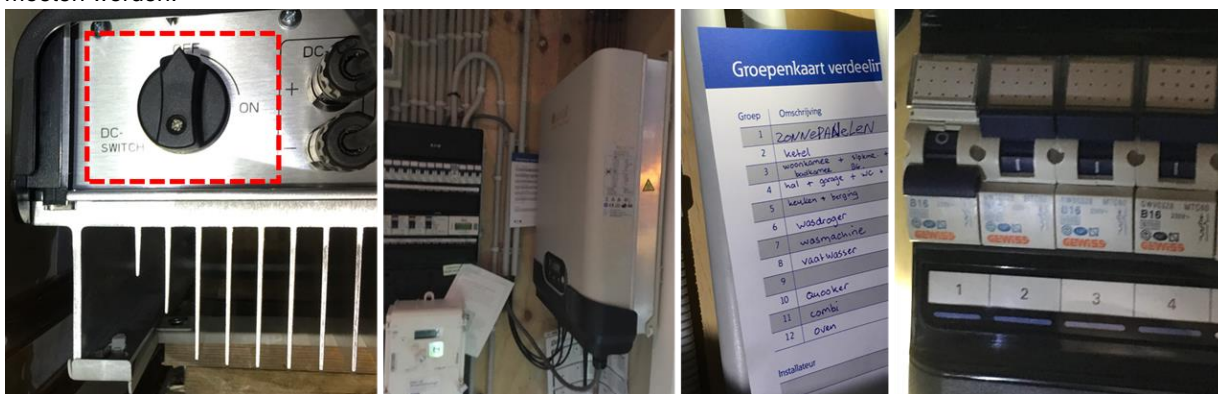
Omvormer in meterkast. DC schakelaar omgezet en betreffende groep uitgeschakeld bij stormschade, bron: Ebus
