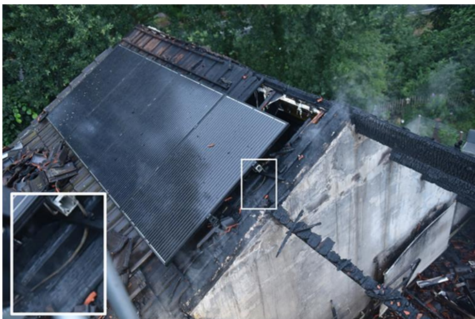
Aangetaste bekabeling van de PV-installatie na een woningbrand. Bron: TBO GM
