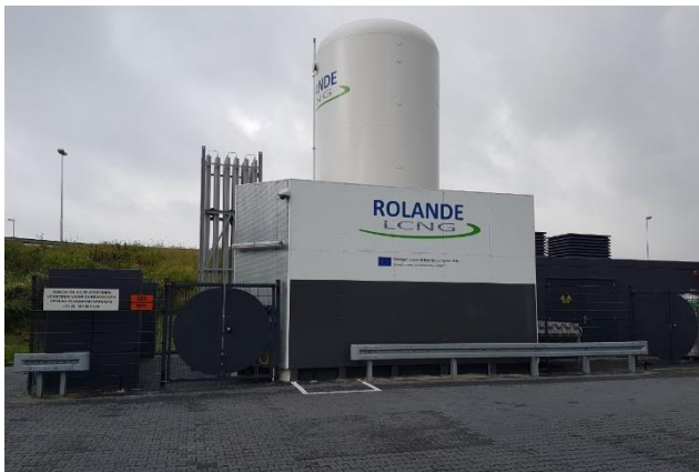
Afbeelding 7.1 Gerealiseerde brandmuur tussen de standplaats voor lossende vrachtwagens en de LNG-installatie (J. Keyser)
