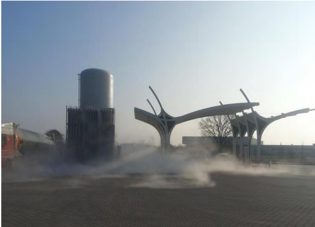
Afbeelding 1.2 LNG-tankstation na het lossen van LNG (Rolande)
