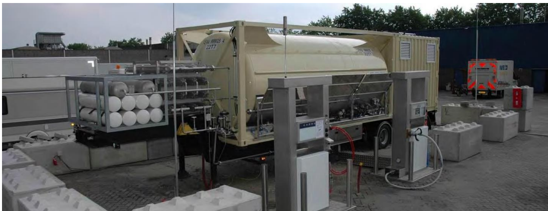
Afbeelding 4.2 Mobiele LNG-installatie (Rolande)
