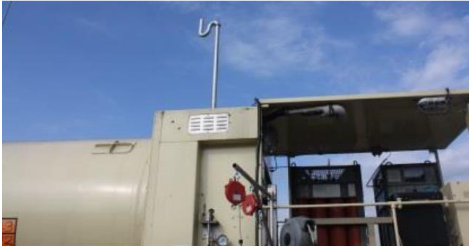
Afbeelding B3.6 Afblaaspijp afleverinstallatie
