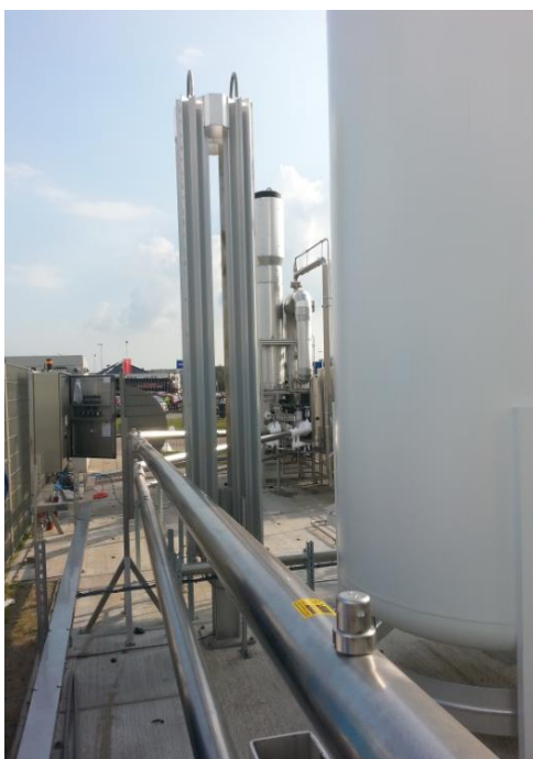
Afbeelding B3.7 Leidingwerk LNG-installatie
