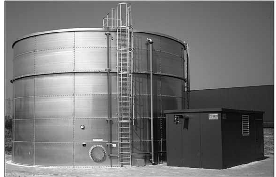
Figuur 3.7 Bovengronds waterreservoir met daarnaast de ruimte waarin de sprinklerpomp is geplaatst
