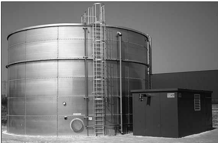
Figuur 6.3 Bovengronds waterreservoir
