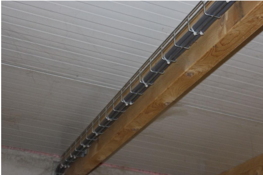
Afbeelding 3.3 Open kabelgoot, waardoor knaagdieren minder kans krijgen om de bekabeling aan te vreten en beschadigingen eerder zichtbaar zijn
