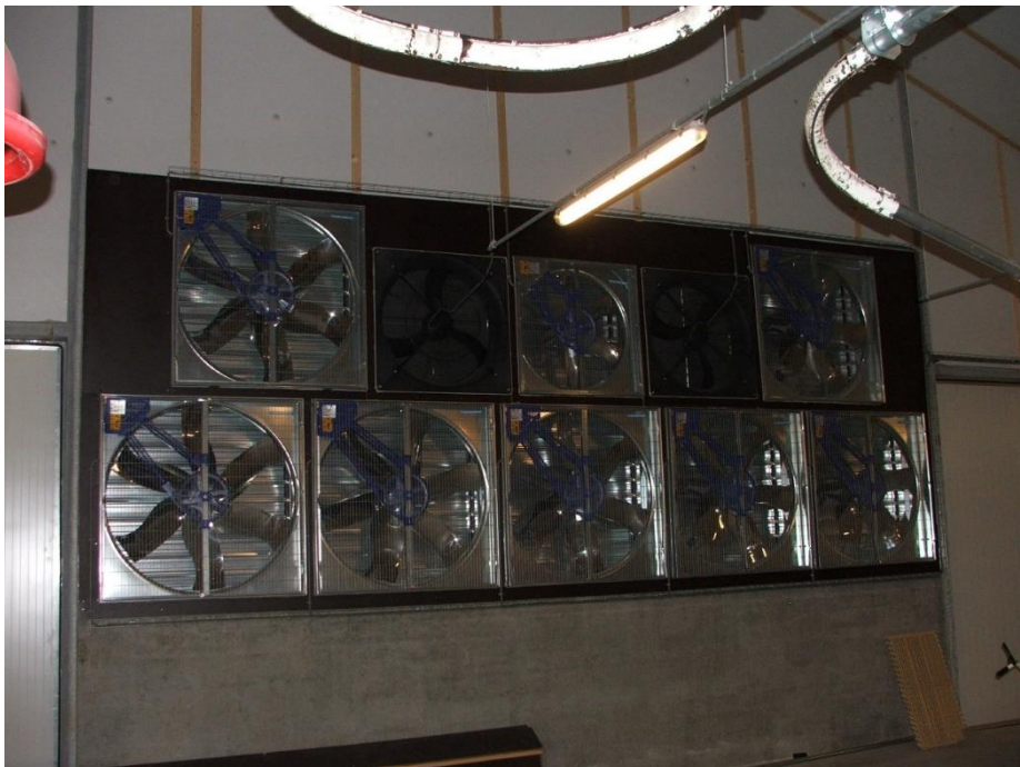
Afbeelding 2.13 Ventilatoren in de achterwand
