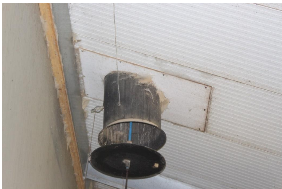
Afbeelding 2.6 Ventilatieschacht in het dak
