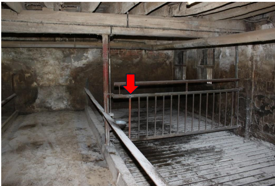
Afbeelding 4.3 Door het lassen van een losse metalen stang (zie rode pijl) van de kalverbox, ontstond er brand in deze mestkelder
