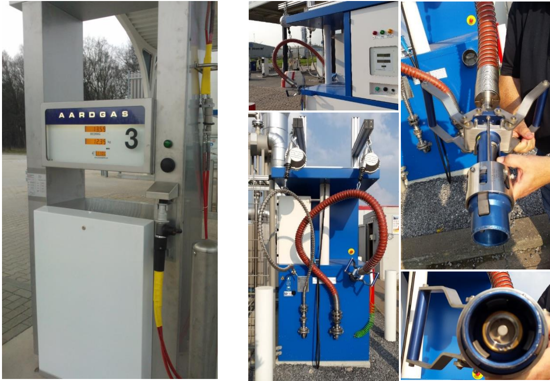
Afbeelding 7.6 Het tanken van LNG
