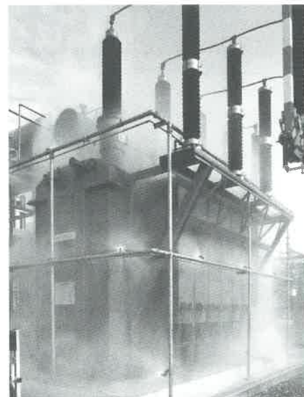
Figuur 2. Watermistinstallatie voor trafo's
