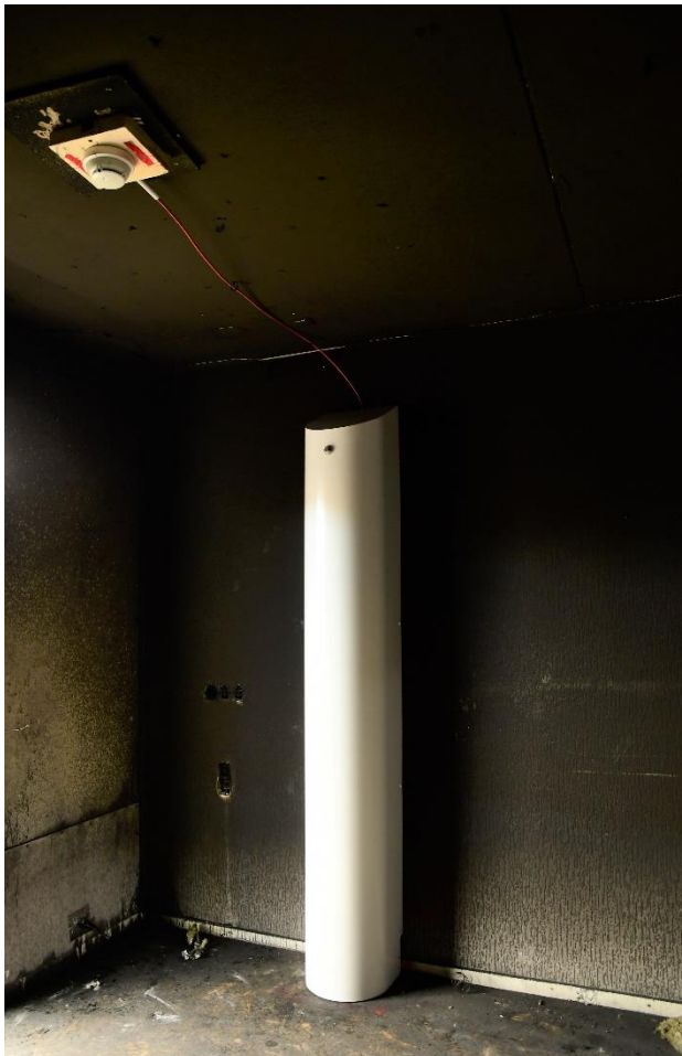
Figuur 3.1 Watermistinstallatie zoals deze is gebruikt bij de praktijktesten in Oudewater.
