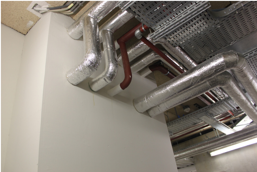
Foto 5.10: Doorvoeringen door respectievelijk niet (boven) en wel brandwerende scheiding (onder)
