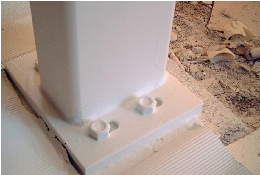
Foto 6.1: Brandwerende constructies door bekleding (boven) en brandwerende verf (onder)
