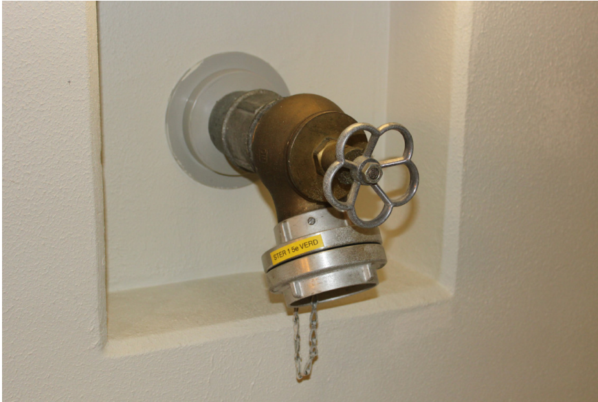
Foto 9.1: Aansluitpunt droge blusleiding
