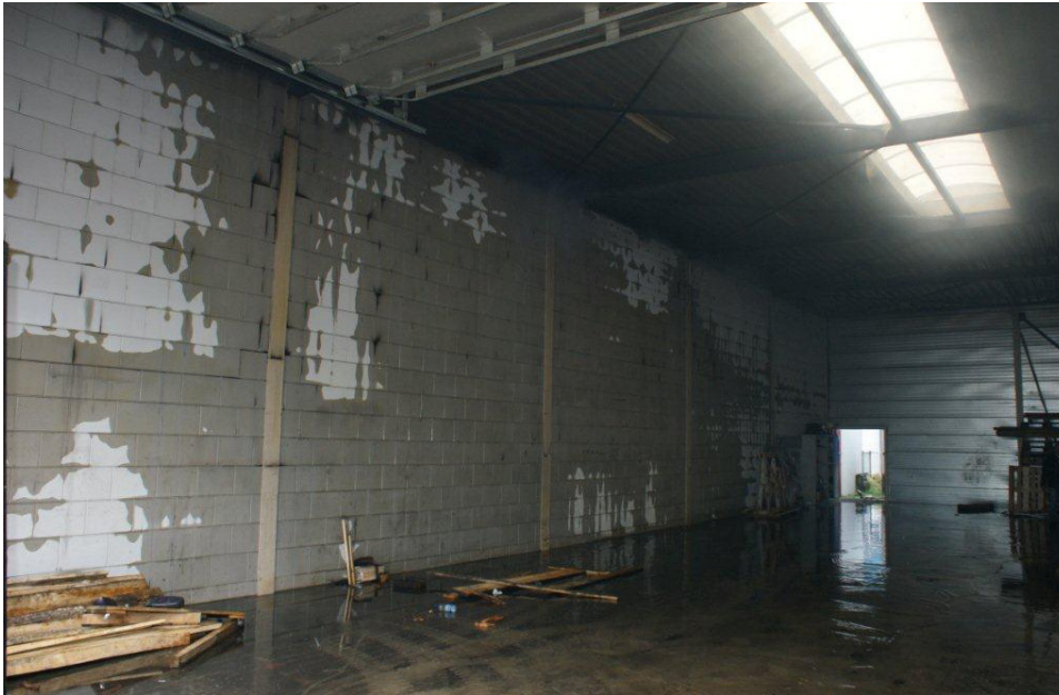
Foto 5.9: Brandwerende scheiding na een brand
