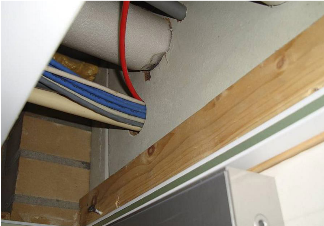
Foto 11.1: In de praktijk teniet gedane brandwerende scheiding
