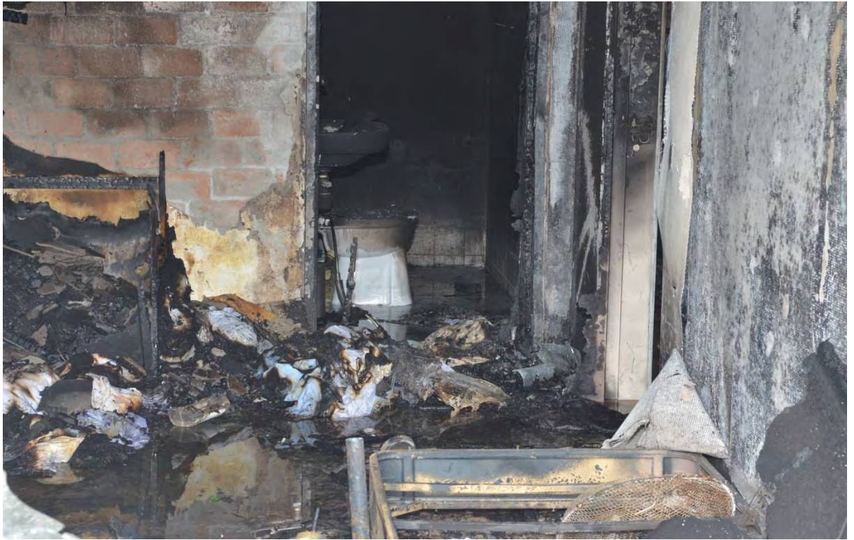
Foto 11. De ontstaansruimte van de brand. Foto: Brandweer Rotterdam-Rijnmond
