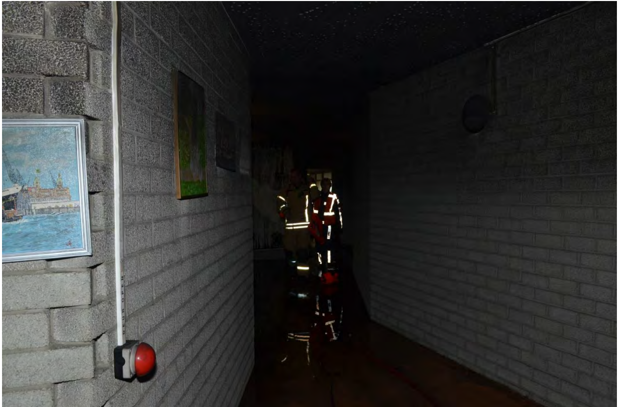
Foto 17. De rookwerende deuren in de gangen waren voorzien van elektrische deuropeners die niet werden onderbroken door rookdetectie. Foto: Brandweer Rotterdam-Rijnmond
