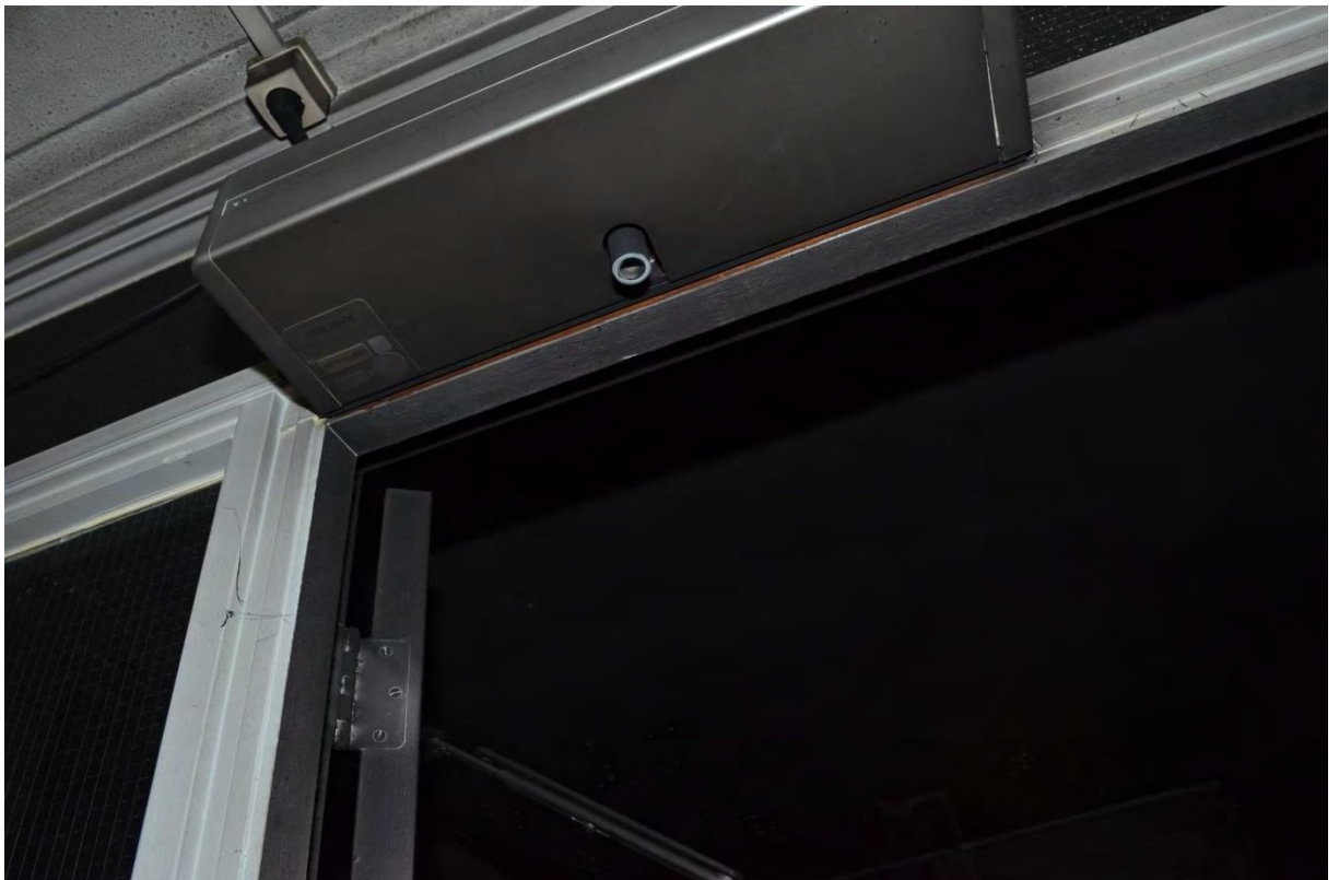
Foto 18. Bij sommige deuren was de deurdranger losgemaakt waardoor deze deuren open stonden tijdens de brand. Foto: Brandweer Rotterdam-Rijnmond
