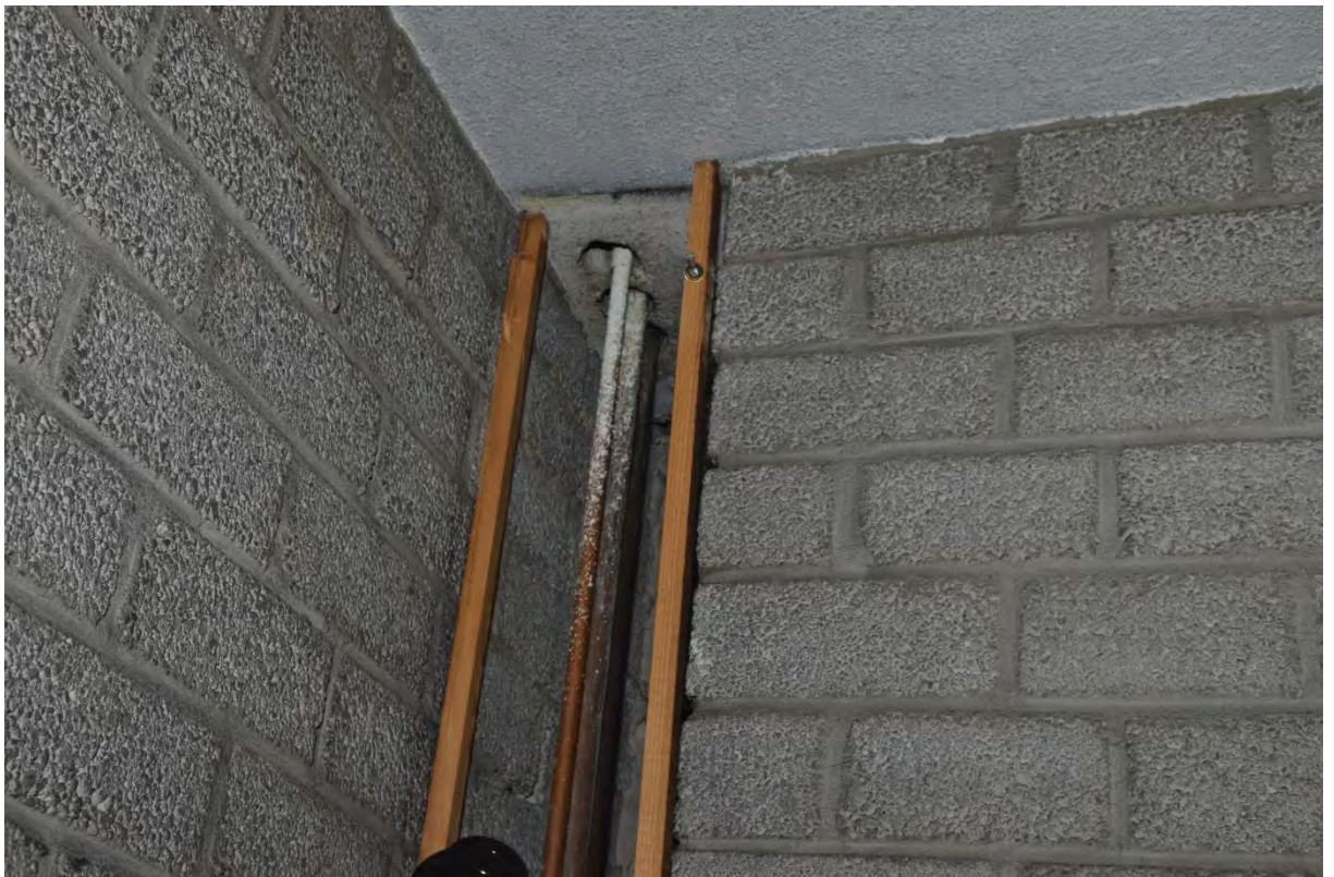
Foto 20. Op de gangen bevonden zich op verscheidene plaatsen doorvoeren met leidingwerk die niet brand- en rookwerend waren afgedicht. Foto: Brandweer Rotterdam-Rijnmond
