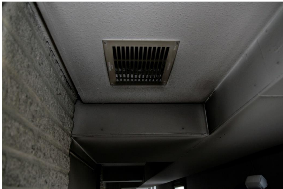
Figuur 5: ventilatierooster galerij
