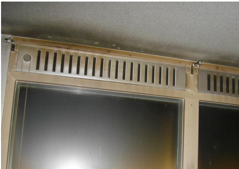
Figuur 6: ventilatieroosters appartement
